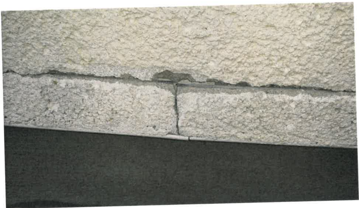
Bild 8: Nord-West-Ansicht – Risse im Bereich Sockelprofil (Ablösung Profil)
