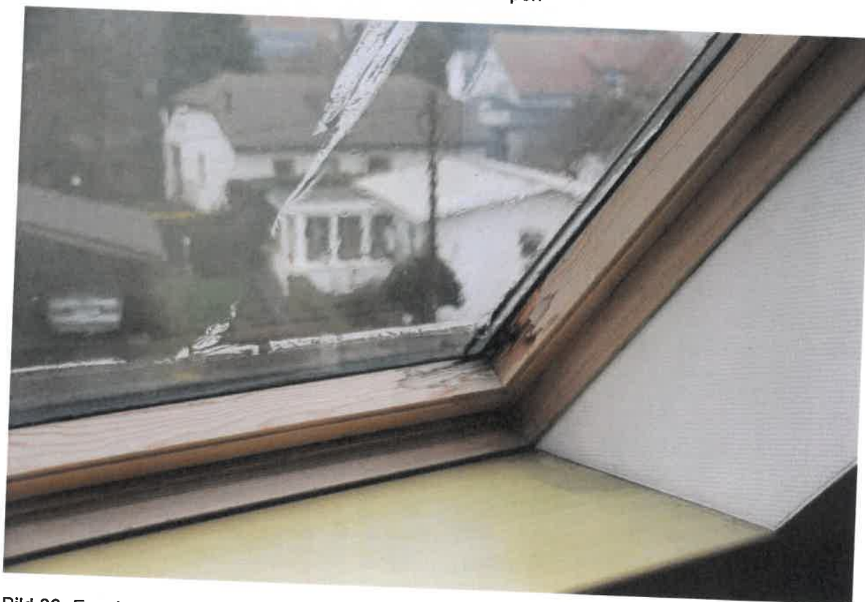
Bild 33: Feuchteschäden am Dachfenster
