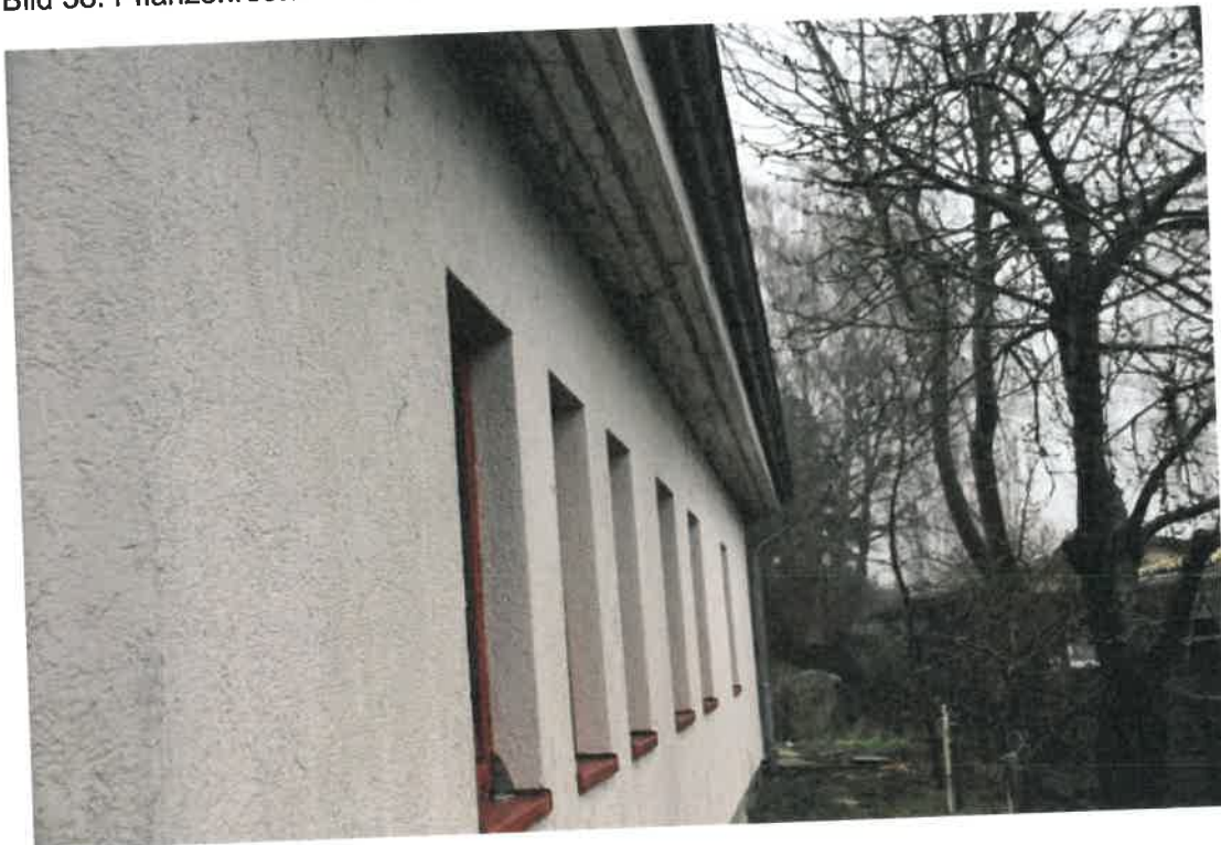
Bild 39: Pflanzenreste an der Dachschalung
