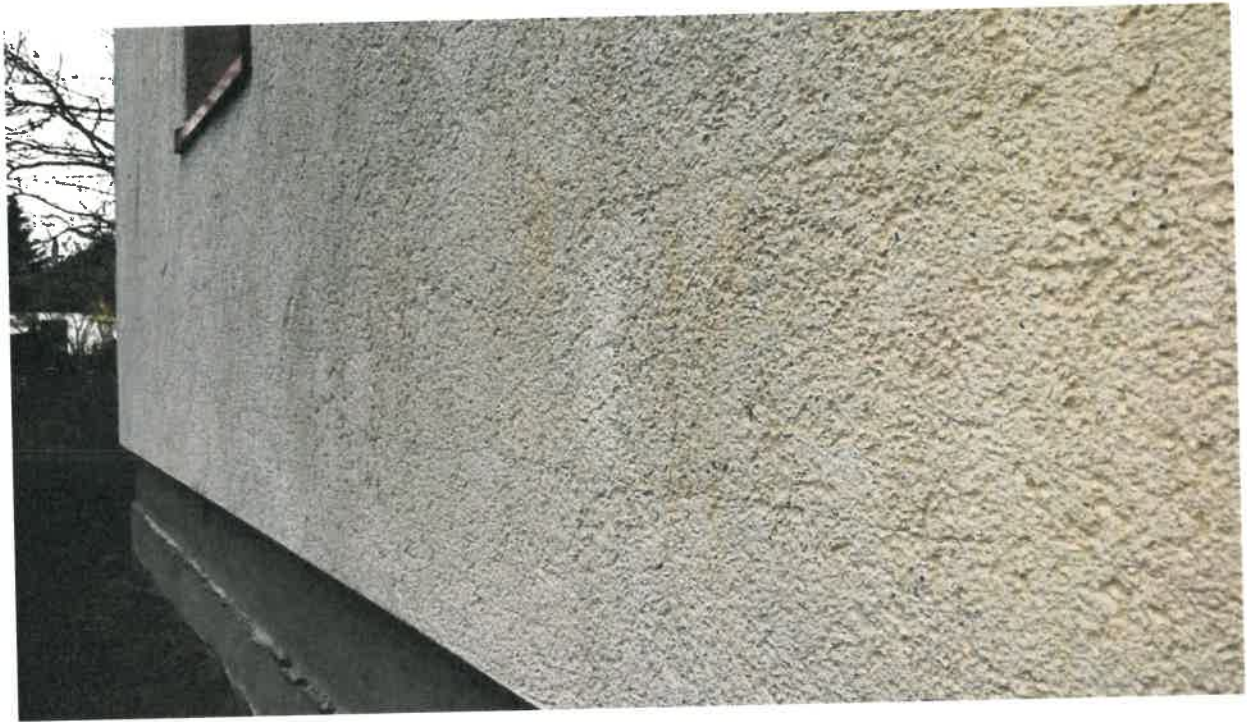
Bild 3: Süd-West-Ansicht, Anbau Bestand – Risse im Bereich von Lager- und Stoßfugen
