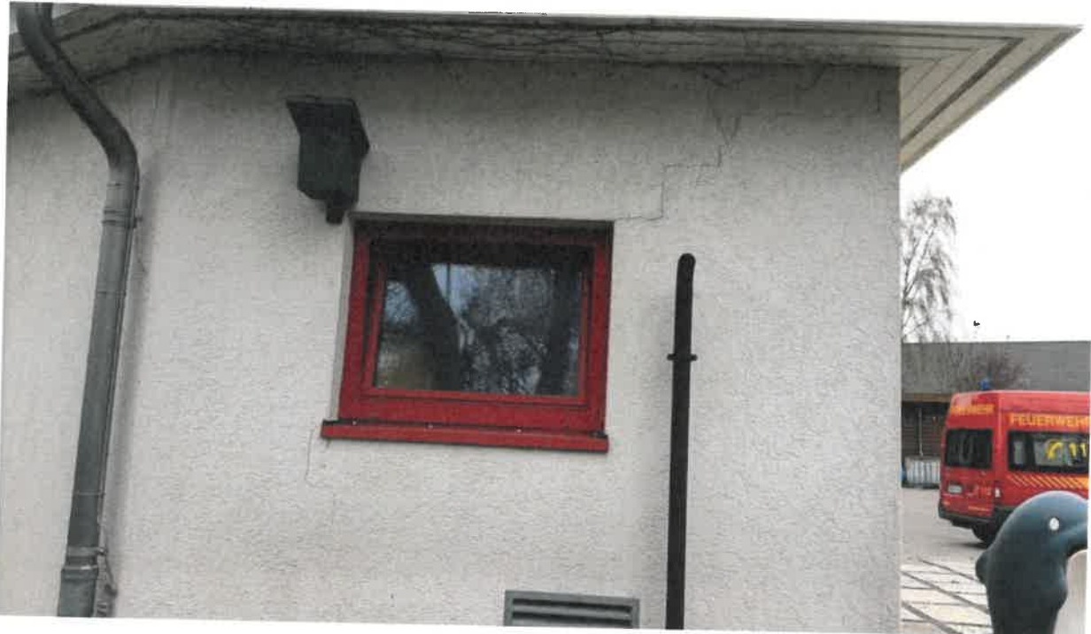
Bild 1: Süd-West-Ansicht, Anbau Bestand, Traforaum – Risse Sturz und Brüstung
