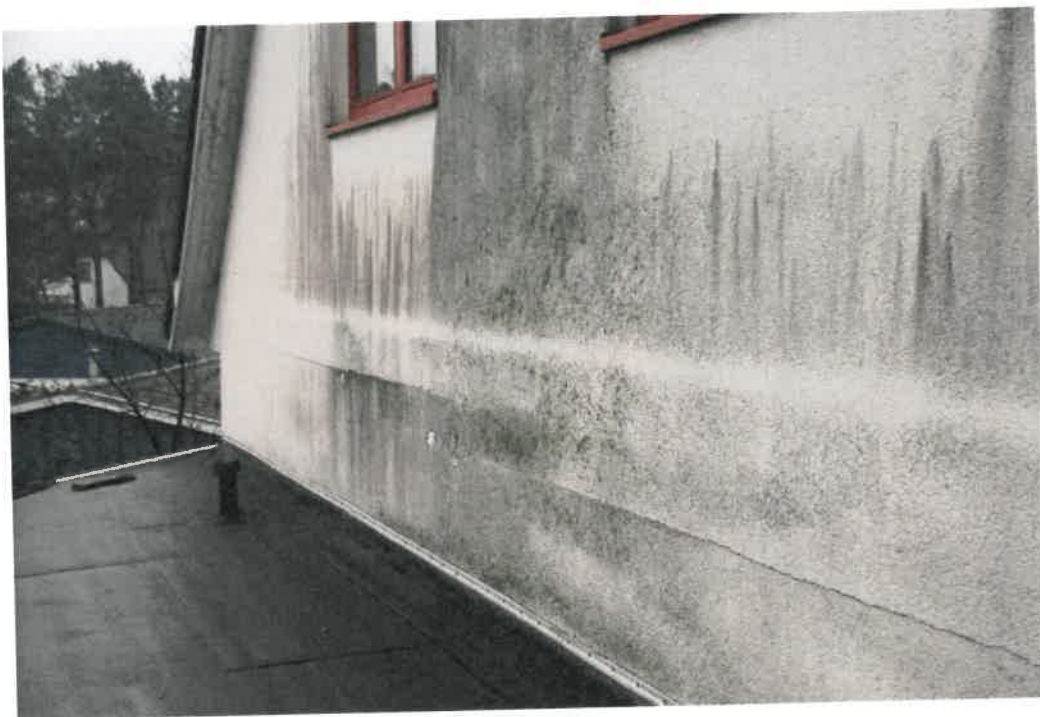
Bild 16: Süd-West-Ansicht – waagerechte Risse unterhalb der Stb-Decke
