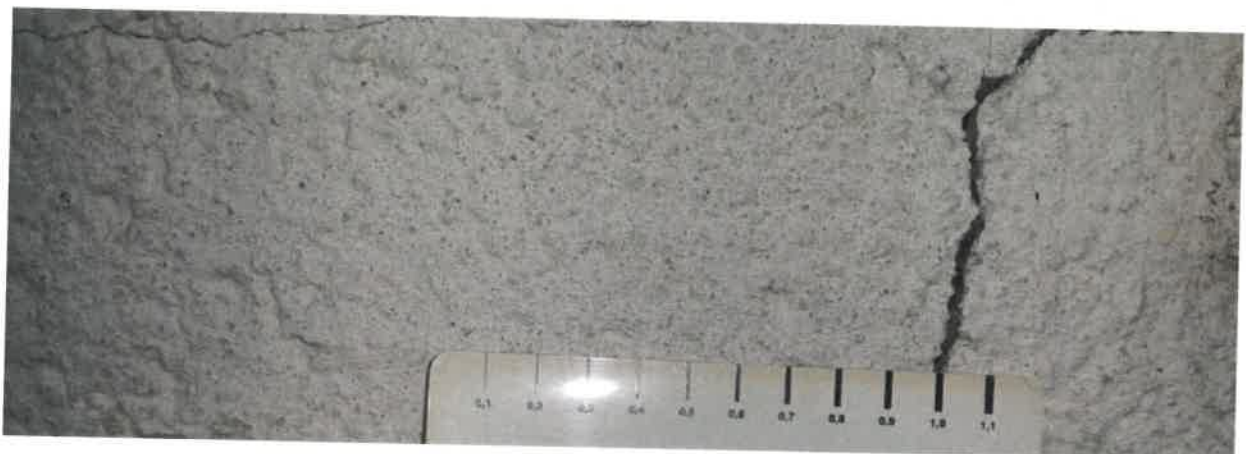
Bild 2: Süd-West-Ansicht, Anbau Bestand, Traforaum – Rissbreite Brüstung
