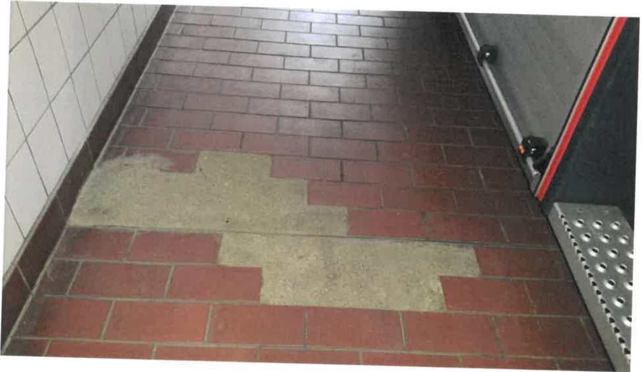
Bild 24: fehlende Fliesen mit Mörtel aufgefüllt
