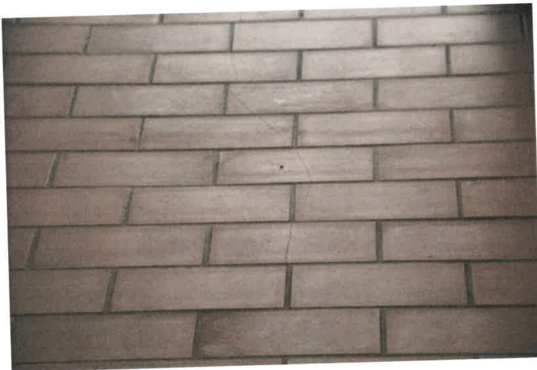
Bild 27: Riss im Fliesenbelag
