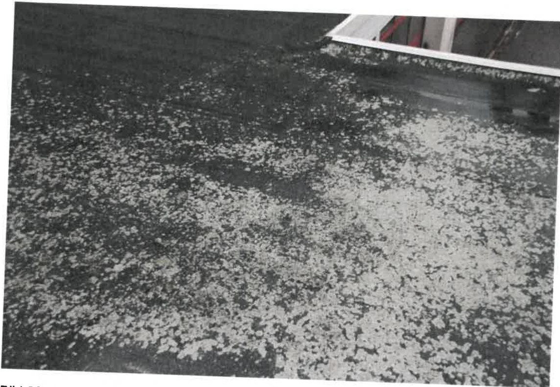
Bild 36: Bewuchs auf der Dachabdichtung des Anbaus
