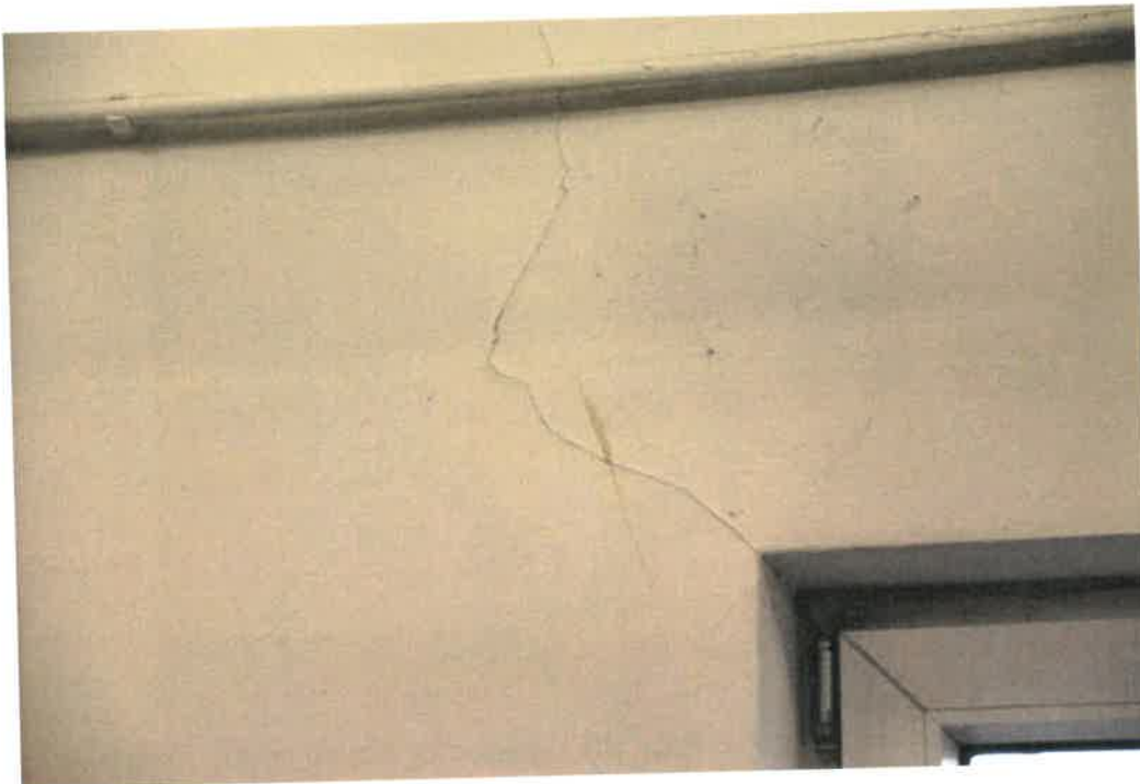
Bild 20: Kerbriss an einer Fensterecke Bereich Sturz
