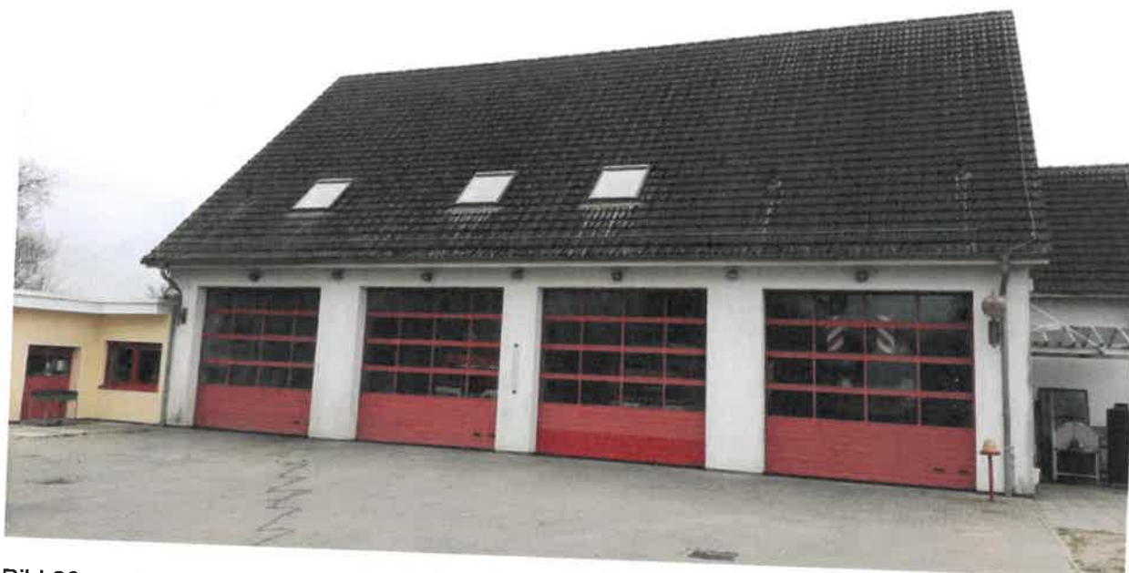
Bild 32: ausgebleichene/abgewitterte Tore und Außenlampen
