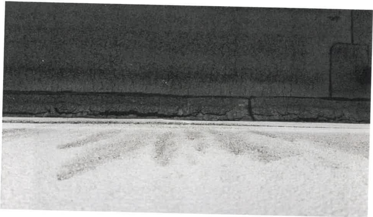
Bild 17: Süd-West-Ansicht – waagerechter Riss unterhalb der Stb-Decke, Wandverschiebung im Riss
