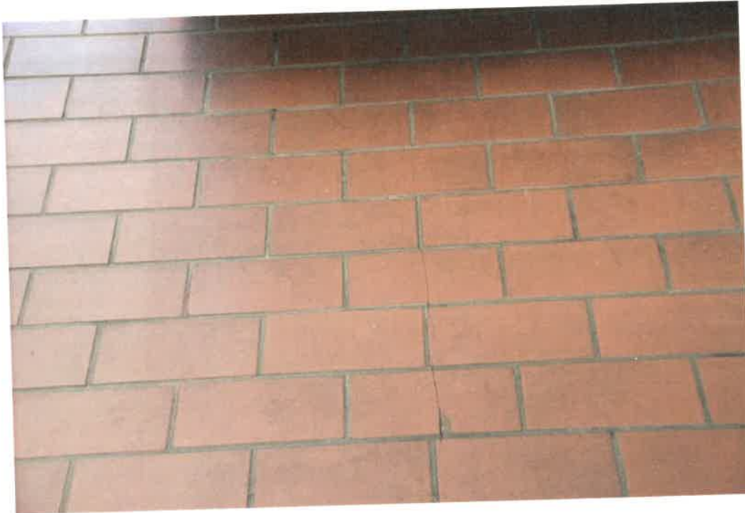
Bild 26: Riss im Fliesenbelag mit Abplatzung an Fliese
