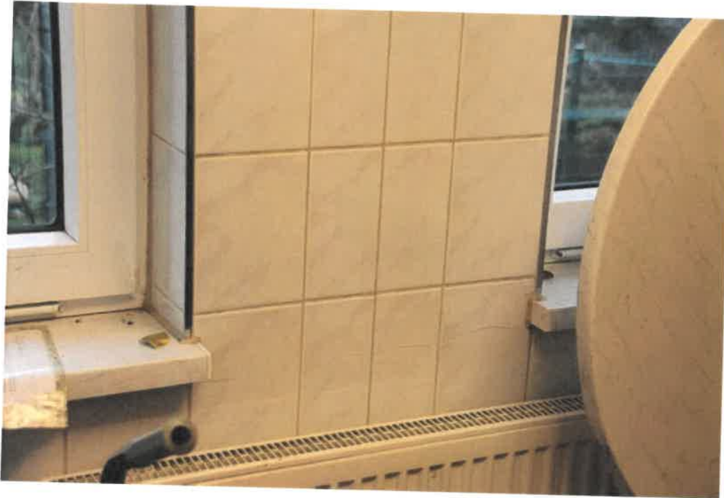
Bild 21: waagerechter Riss Wandfliesen Bereich Brüstung
