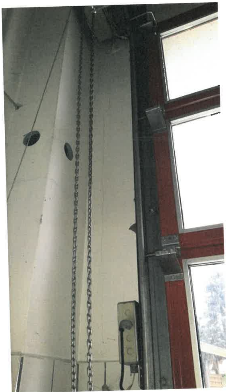
Bild 23: vertikaler Riss an Ringanker vertikal
