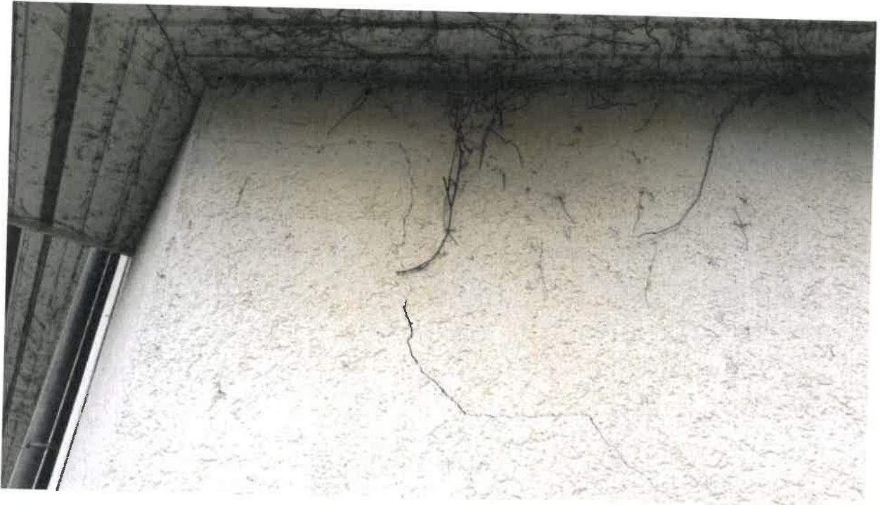
Bild 5: Süd-West-Ansicht, Anbau Bestand – Risse im Bereich Gebäudeecke
