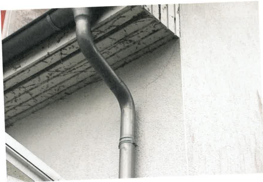
Bild 38: Pflanzenreste an der Dachschalung
