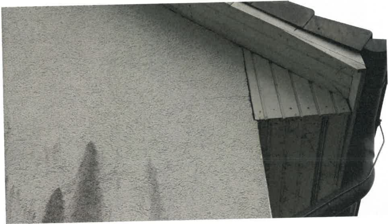
Bild 11: Nord-Ost-Ansicht – Risse Dachanschluss
