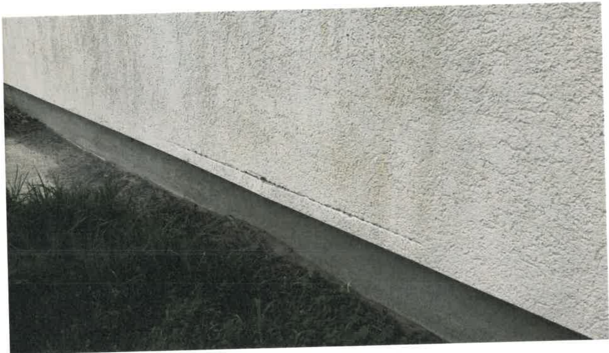
Bild 7: Nord-West-Ansicht – Risse im Bereich Sockelprofil (Ablösung Profil)
