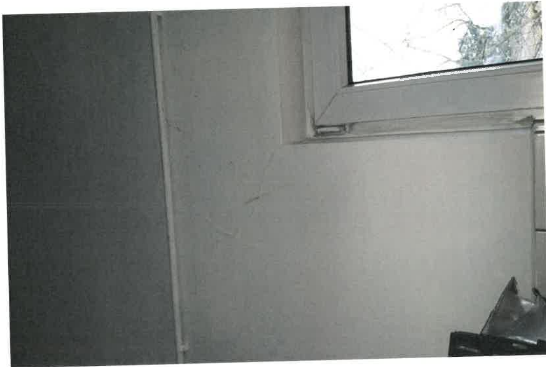
Bild 19: Kerbriss an einer Fensterecke Bereich Brüstung
