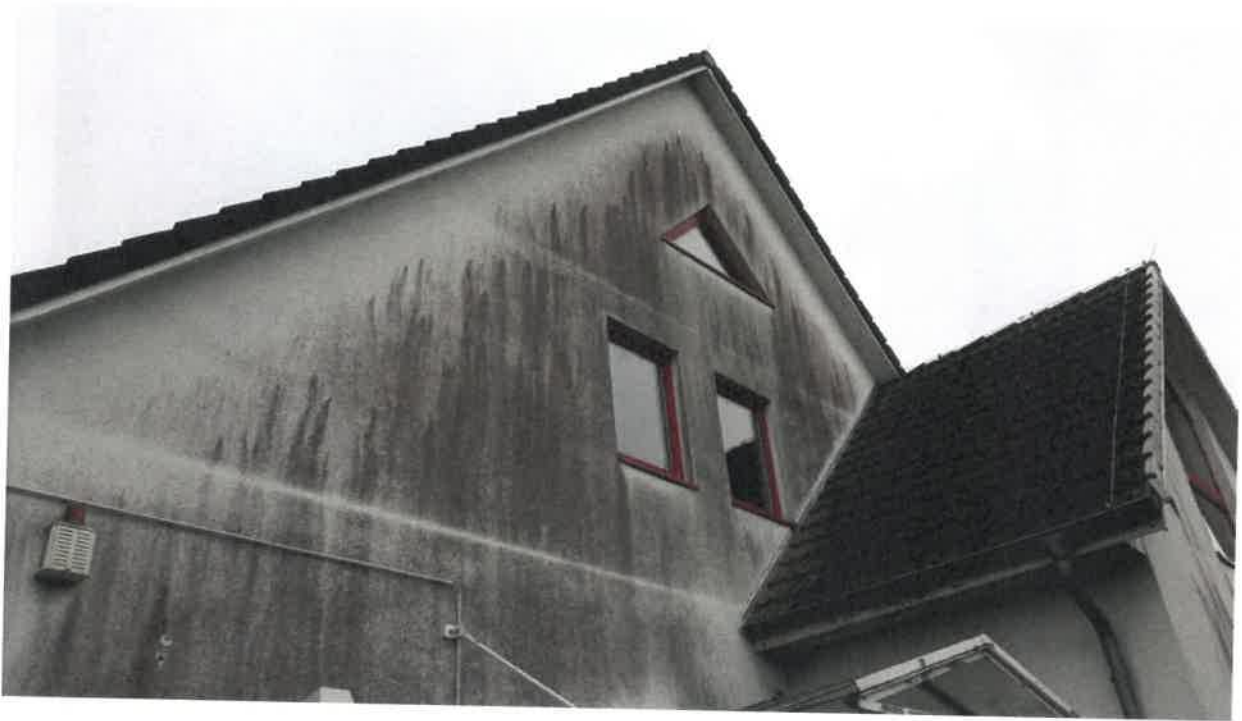
Bild 13: Nord-Ost-Ansicht – Algen an der Fassade
