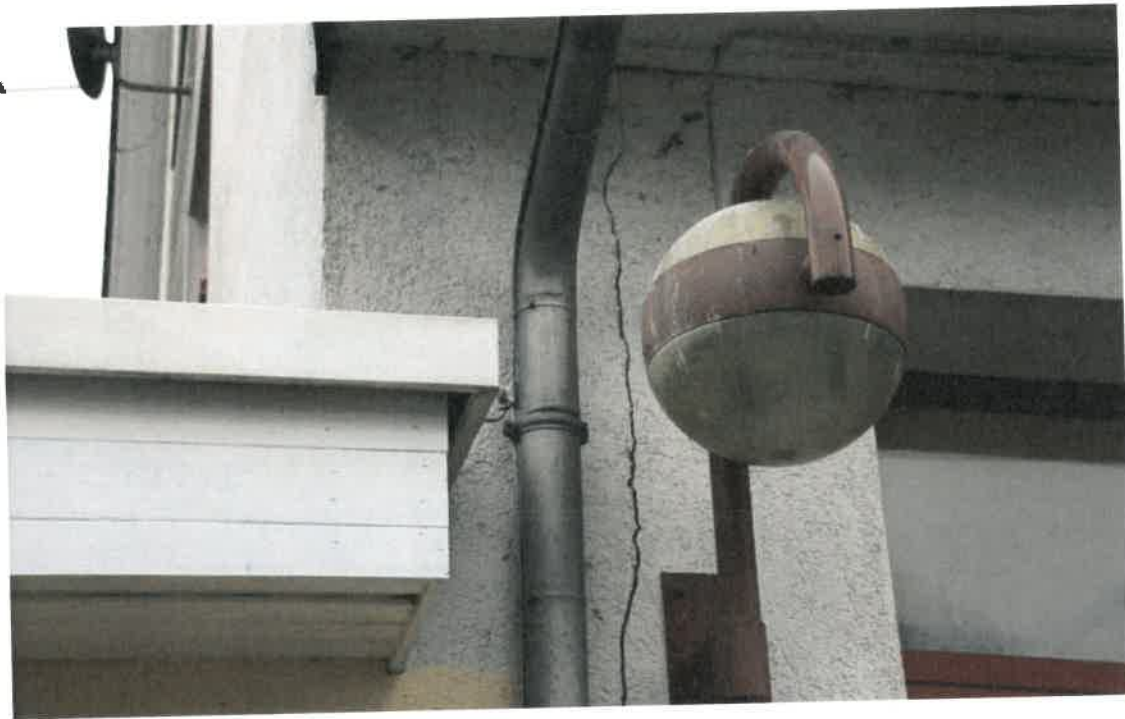
Bild 15: Süd-Ost-Ansicht – vertikaler Riss am vertikalen Ringanker
