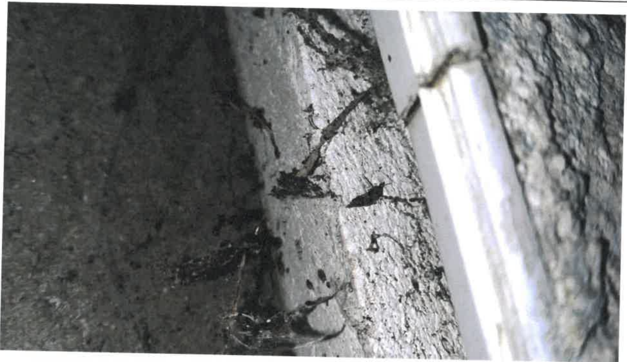
Bild 9: Nord-West-Ansicht – fehlende Abdichtung am Absatz im Sockel
