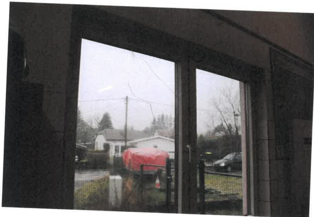
Bild 29: Risse in der Verglasung
