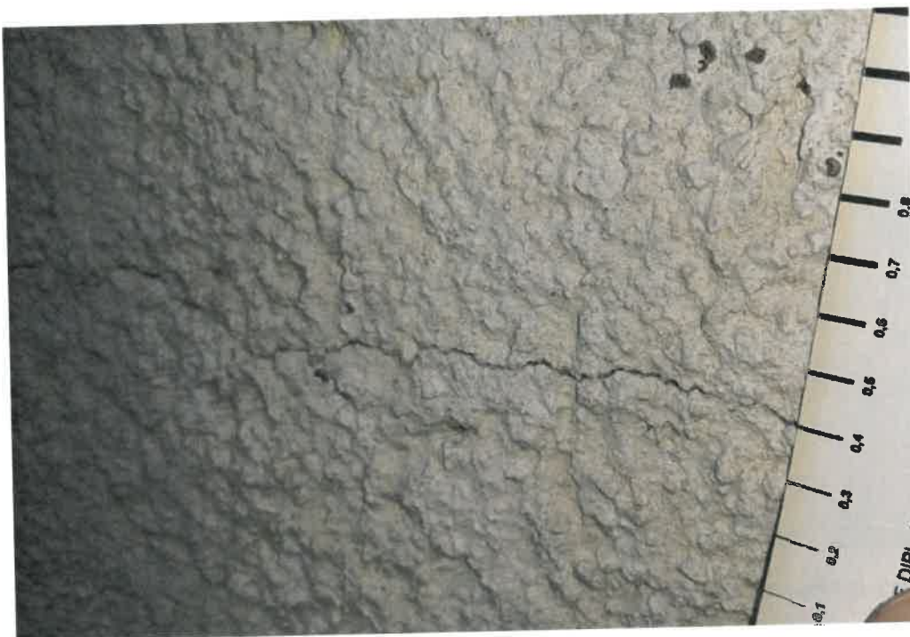
Bild 4: Süd-West-Ansicht, Anbau Bestand – Rissebreite im Bereich von Lager- und Stoßfugen
